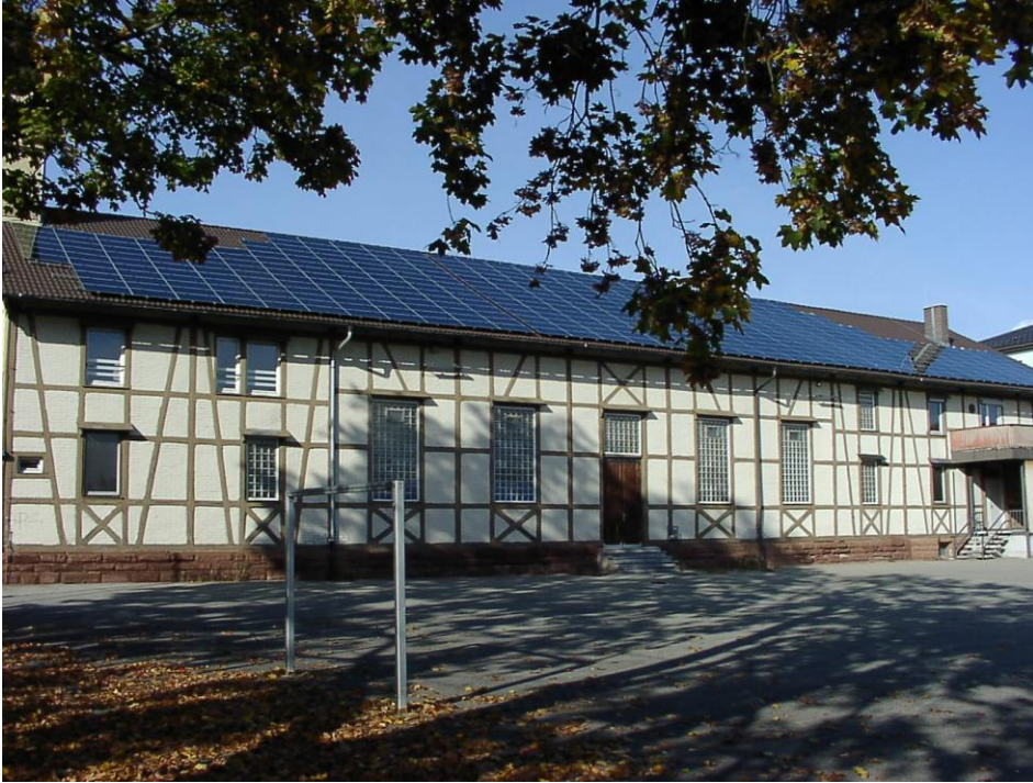
Abbildung 34: PV-Anlage auf dem Dach der Bürkturnhalle
